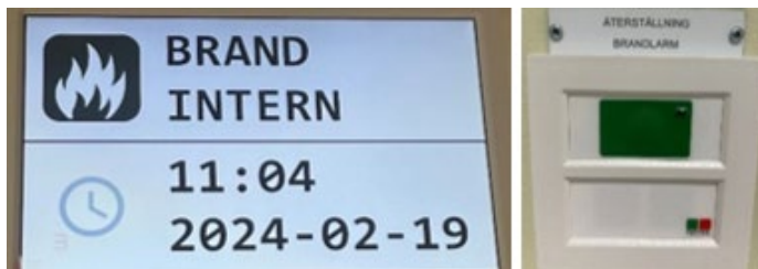
Figur 2. Skylt på kallelsesignalsystem till vänster och återställningsknapp till höger.
