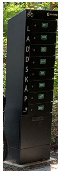
Figur 6. Obrännbart förvaringsskåp med individuellt låsbara fack med/utan laddning utomhus
